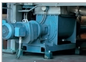
Pompes WANGEN KL-R en service
