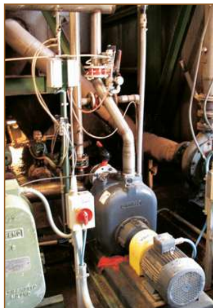
Production d'aggloméré Productie spaanplaat Spanplattenproduktion
